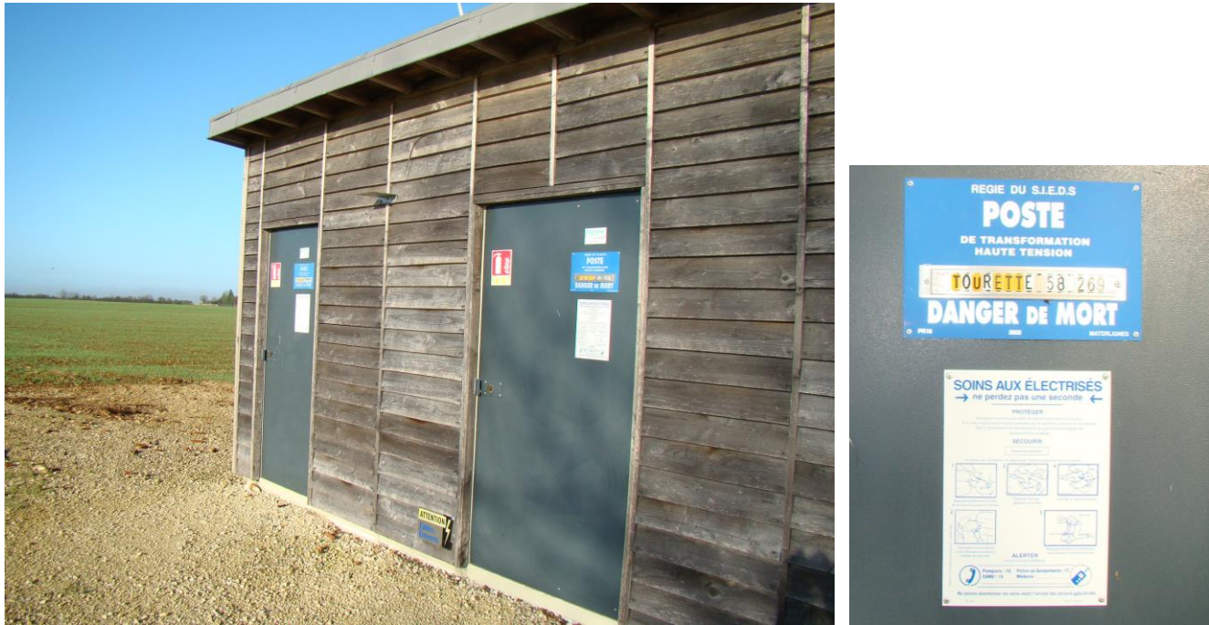
Figure 2 - affichages sur poste électrique de livraison
